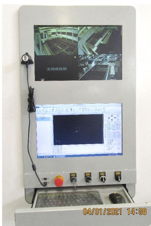
Рис. 3 Вид панели управления.
